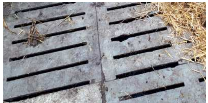
Abbildung 4: Roste mit ausgebrochenen Spalten müssen ersetzt werden
